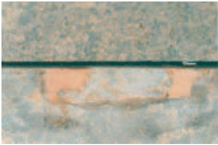
Bild 7: Unzulässig sind solche mit Epoxidharz geflickten Ankerausbrüche. Die Standsicherheit der Natursteinplatte lässt sich auf diese Weise nicht wieder herstellen!
