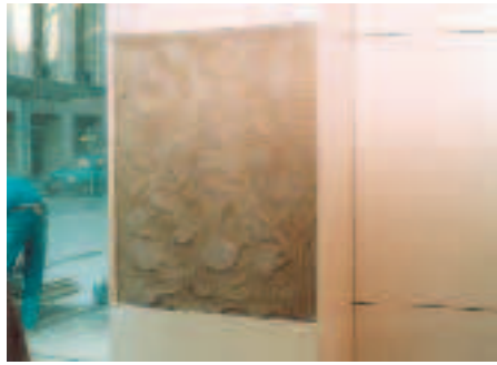
Bild 5: Klebevermörtelungen sind gefährlich: Die großformatige Natursteinplatte ist abgefallen.
