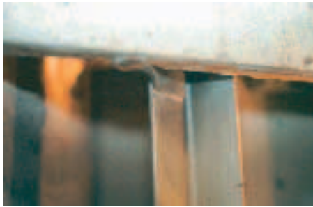
Bild 4: Bauseits angeschweißter Halteanker mit offener Fuge.
