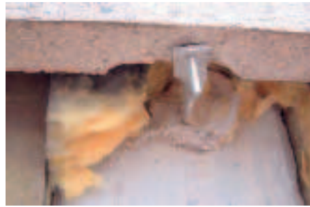
Bild 8: Besonders gefährlich sind Ankerausbrüche zur Rückseite der Natursteinplatte.
