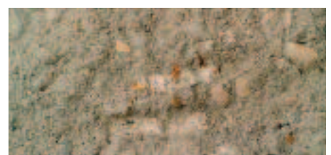
Bild 4: Rostige Zuschlagskörner in der obersten Schicht des Estrichs.
