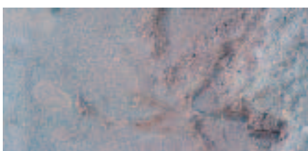
Bild 2: Rostanlagerungen an der Plattenrückseite.
