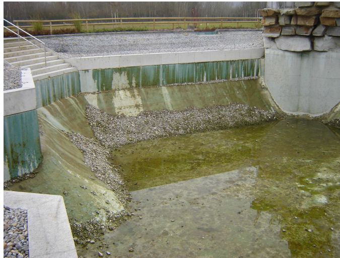
Bild 2.2.1: Starke Kalkausblühungen auf der Teichfolie und den Natursteinen
